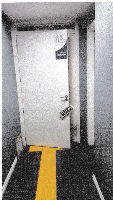
9º Banheiro feminino interditado – 15/08/2024
