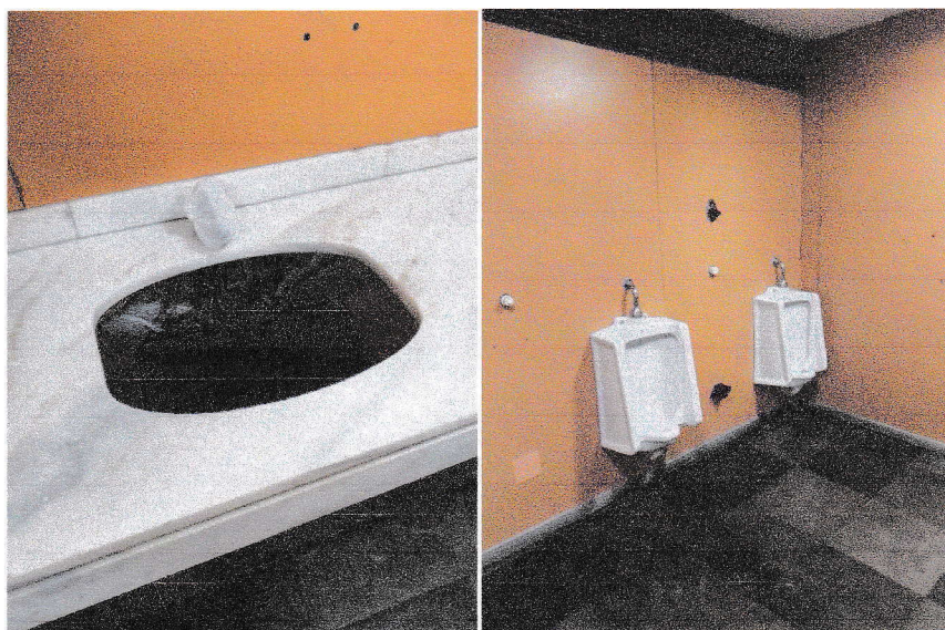
18º Andar banheiro masculino sem cuba e mictório – 15/08/2024
