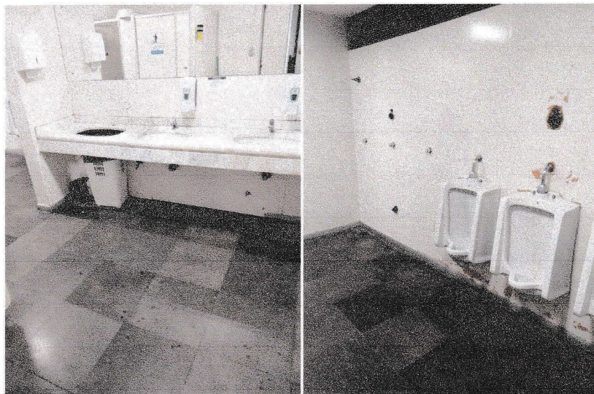
19º andar banheiro masculino sem duas pias e mictório – 15/08/2024
